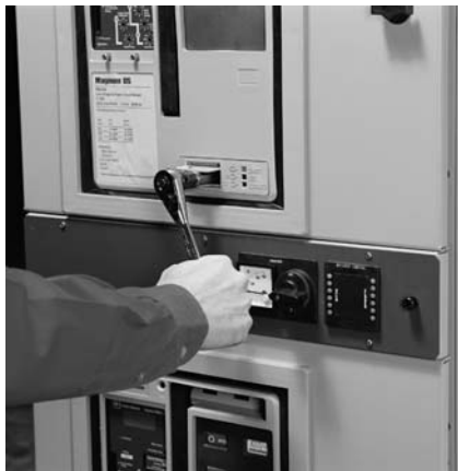
Levering Magnum DS Breaker
